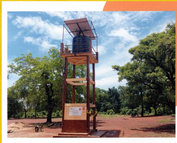
2022: Solarwasser- anlage in Bitchabe Togo
